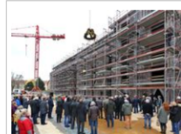
BEI EISIGEM WIND feierten Stadt und Bauherrin SVG Wohnen gemeinsam mit ehemaligen und künftigen Mietern an der Berckmüllerstraße Richtfest. Hier entstehen 53 neue Wohnungen. Foto: Fränkle
